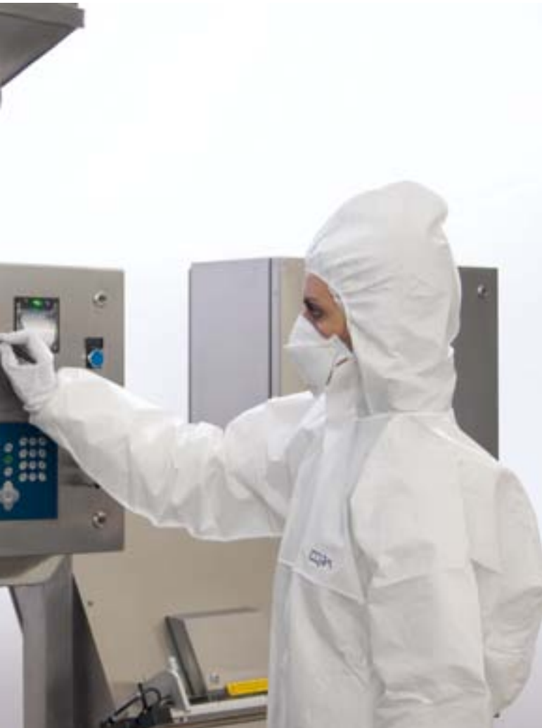
Dettaglio quadro di comando con pannello HMI Detail of control panel with HMI panel
