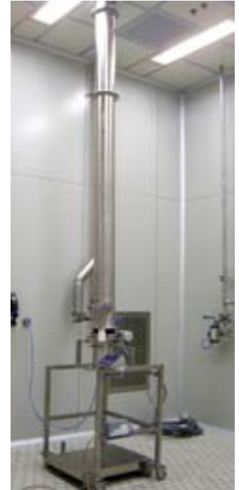
Sistema dosaggio liner continuo, scarico e dosaggio da essiccatore Continuous liner dosing system, discharge and dosing from a dryer
